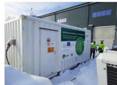
Jednotka na čistenie a skvapaľňovanie oxidu uhličitého (PuLi). Zdroj: VTT
